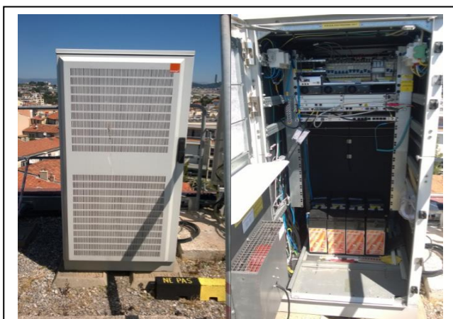
Figure 3 : Atelier énergie 48V
